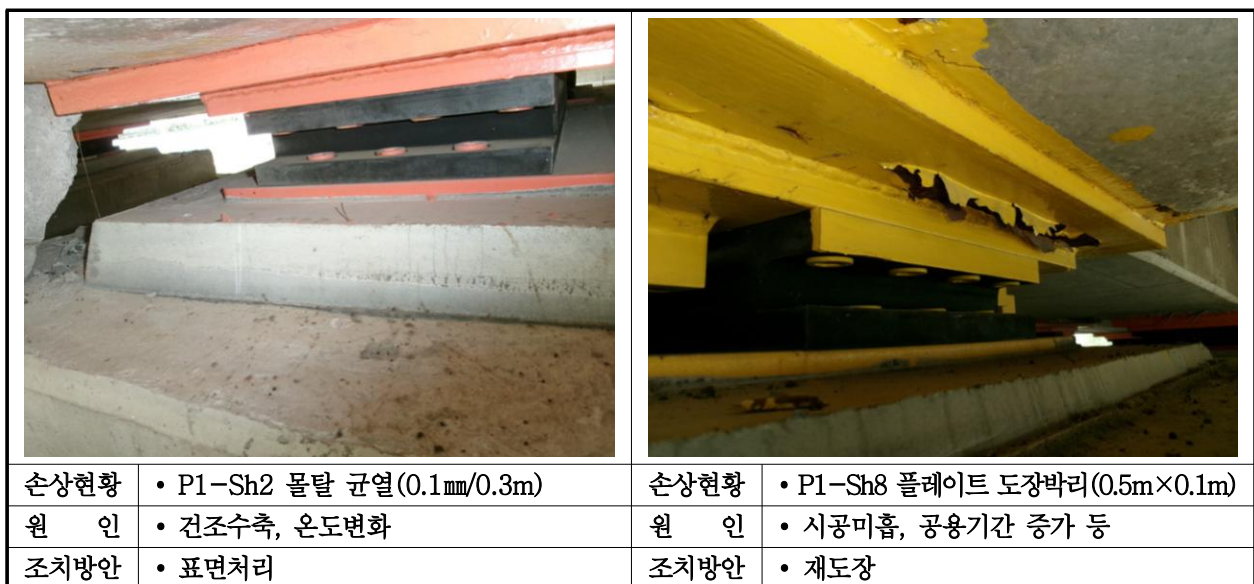
【사진 21.3.13】 교량받침 손상현황
